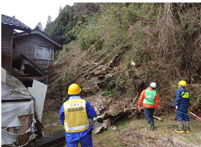
② 輪島市町野町徳成谷内地区 (現地調査状況)
